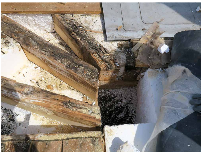
Abb. 3: Moderfäule an Holzunterkonstruktion unter der Dachschalung [© Autor]
