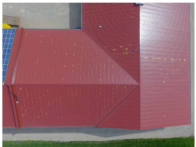
Abb. 12: Übersicht über die Dachflächen – Blasenbildungen gelb gekennzeichnet [© Autor]
