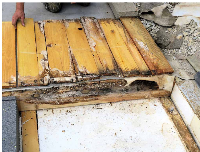
Abb. 4: Moderfäule an Holzunterkonstruktion und Dachschalung [© Autor]
