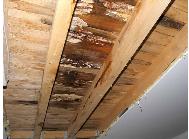
Abb. 6: Durchfeuchtung und Pilzbefall an der Dachschalung [© Autor]
