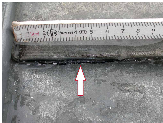
Abb. 8: Riss an Querfalz [© Autor]
